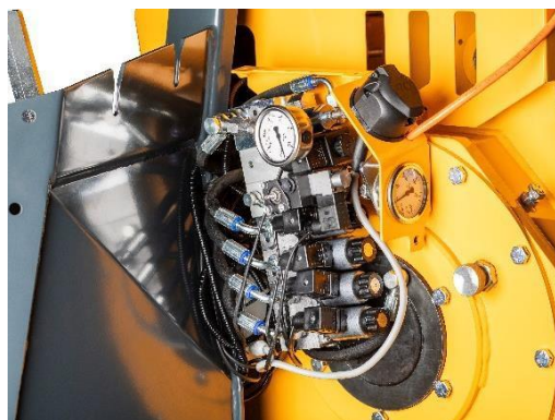
Nový hydraulický blok
